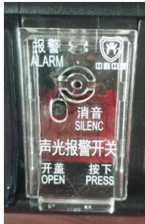
灭火器手动控制开关照片
