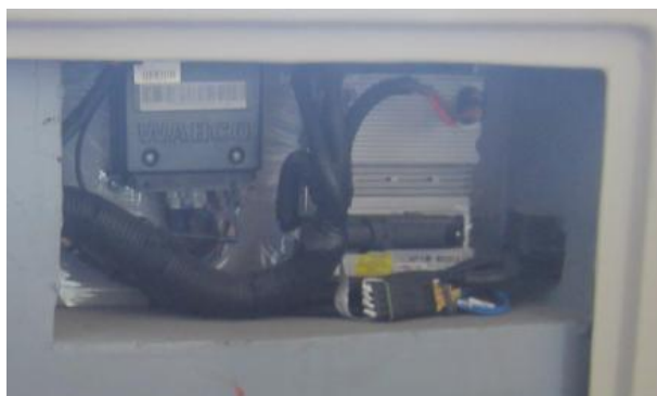
仪表台右侧电器仓内
